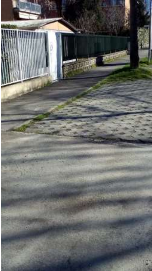
Via Milano angolo Via Treves: aiuola asfaltata?
